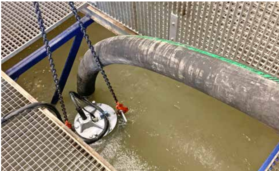
Das unterirdische Prüfbecken verfügt über induktive Durchflussmesser und eine elektrische Prüfanlage zur Durchführung der wiederkehrenden Geräteprüfung nach ÖVE E8701.
